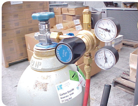
Foto 7 – Detalhe da válvula reguladora de pressão instalada no cilindro de CO 2
