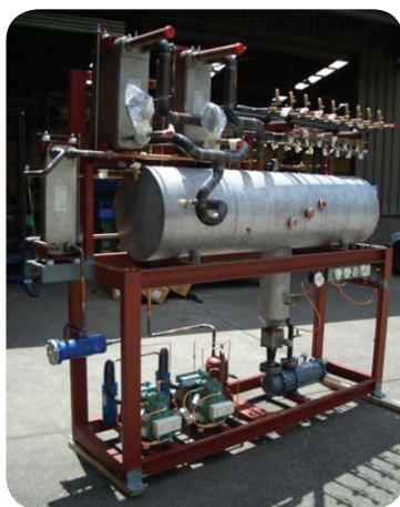
Foto 14 – Detalhe do rack com sistema de bombeamento do CO 2 líquido
