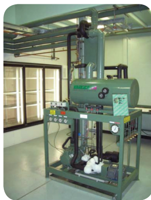
Foto 6 – Rack para operação subcrítica com CO 2 utilizando bomba de recirculação para os evaporadores de média temperatura de evaporação
