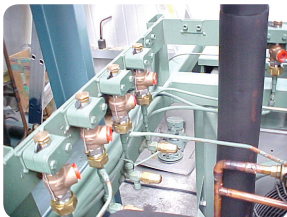
Foto 1 – Válvulas de segurança instaladas no rack
