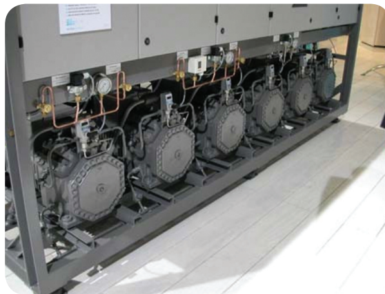
Foto 3 – Rack com aplicação transcítica de \text{CO}_2
