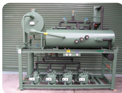
Foto 13 – Detalhe do tanque de líquido montado no rack “isolado” termicamente
