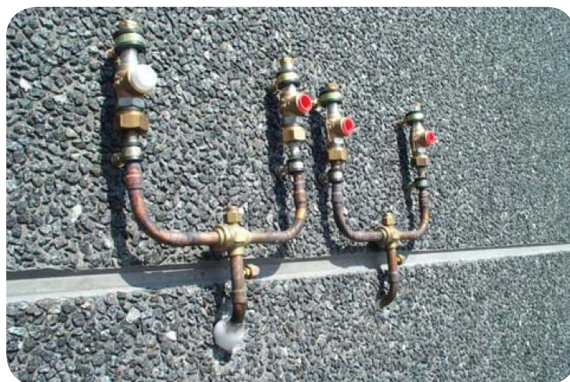
Foto 2 – Válvulas de segurança instaladas fora da sala de máquinas, “sem tubulação na saída das válvulas para evitar bloqueio por gelo”
